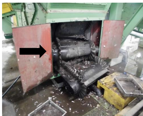
焼損・脱落したベルト
